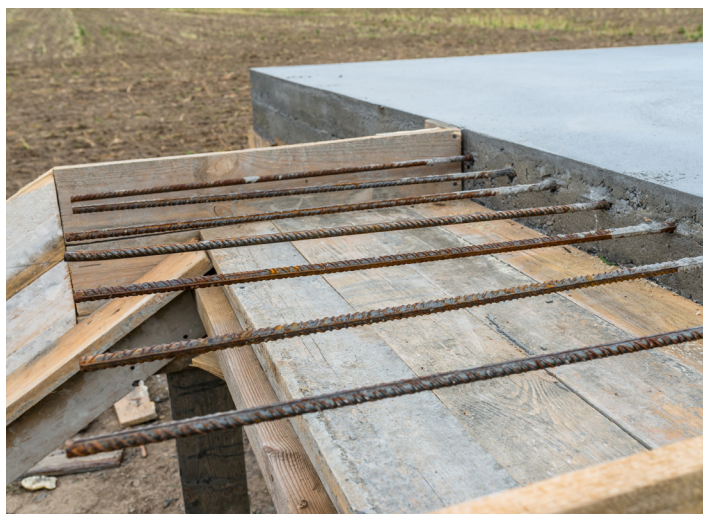
Figura 1.20 Exemplos de situações quando armaduras permanecem expostas por algum tempo
